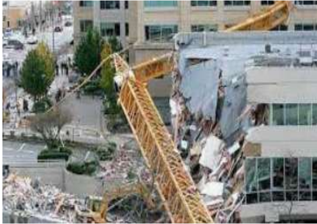
Figure 5 : Chute d'une grue dans un chantier
